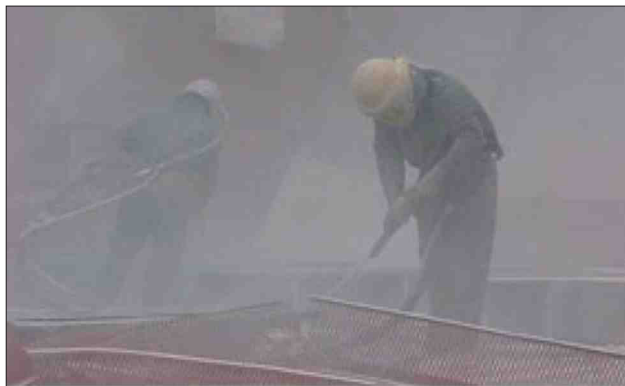
El chorro abrasivo produce altos niveles de polvo. Foto cortesía de NIOSH.
