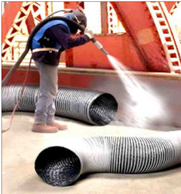
Chorreado abrasivo con un sistema de recolección de polvo con múltiples ductos de escape. (Foto cortesía de Flexaust, Inc. Se muestra este equipo solo con fines de ilustración y no se incluye como una aprobación de esta compañía, sus productos o servicios por parte de la OSHA.)
